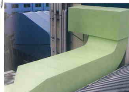
ダクトの放熱防止
